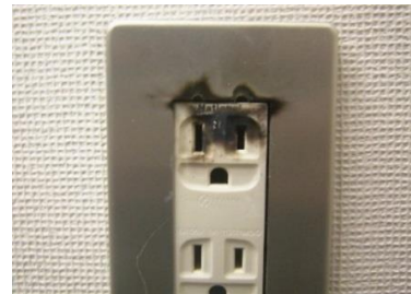
コンセントのこげ跡
