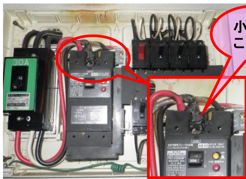
ブレーカーの小さなこげ跡
