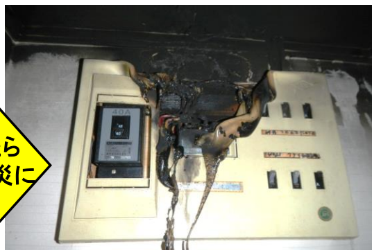
ブレーカーが燃えた火災
