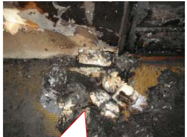
焼損したトイレットペーパー
