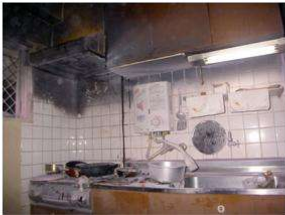
写真 1 台所の焼損状況
