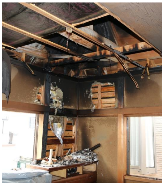
写真1-1 神棚付近の焼損状況
