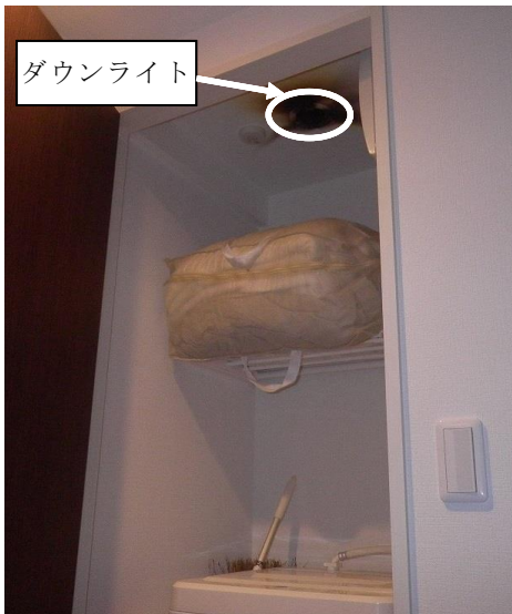
写真 1-1 洗濯機置場の焼損状況
