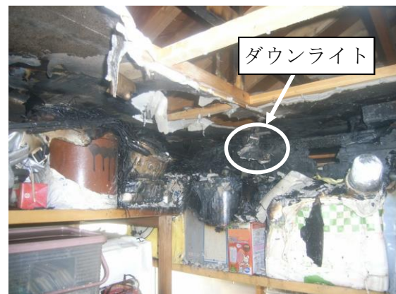
写真 2-2 焼損した荷物とダウンライト
