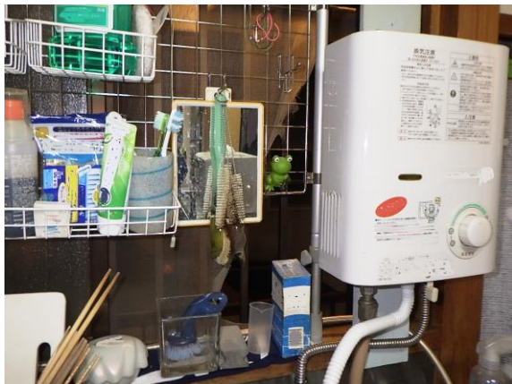
写真 2-1 網戸の焼損状況
