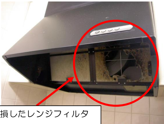
写真 1-1 焼損したレンジフィルタの状況
