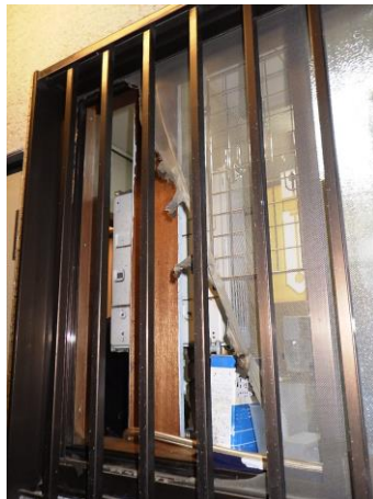
写真 2-2 網戸の焼損状況（共用廊下側から）
