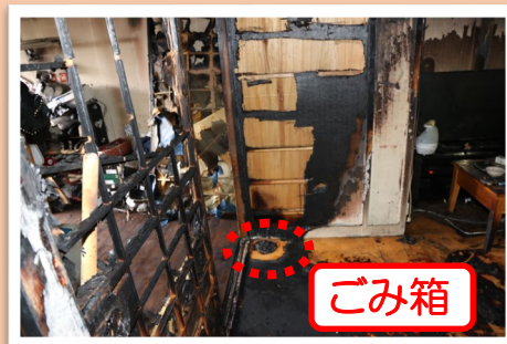
事例1 焼損状況
